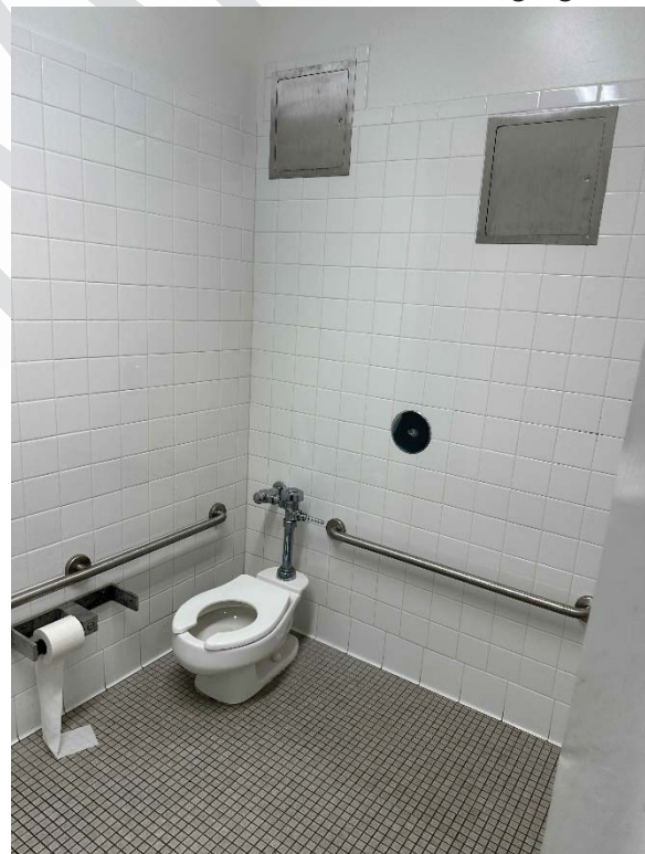
ADA compliant toilet
